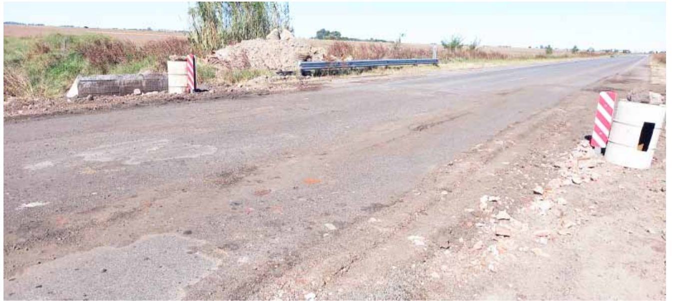
La ruta 65 a la altura del corte, mal señalizada y con un pavimento muy deteriorado.
