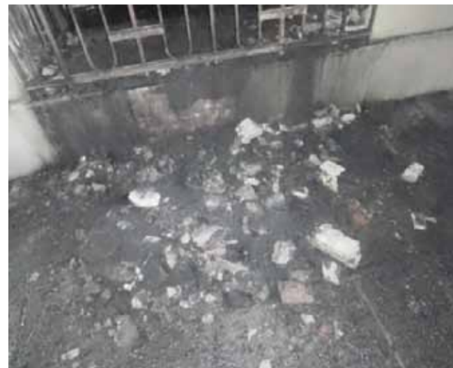
También en el lugar había restos de maderas y tejas quemadas y la vereda está manchada presuntamente con aceite, lo que acrecienta la hipótesis de que se trató de un acto vandálico.
