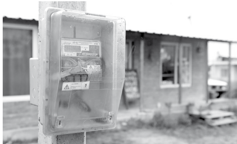
Novedades. Sobre el servicio eléctrico. - DIB -
