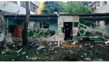
Un edificio dañado en un ataque.
